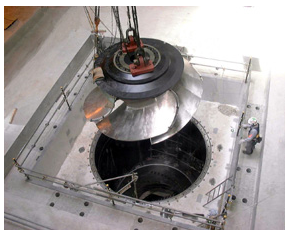
世界最大級の排水ポンプ設備
