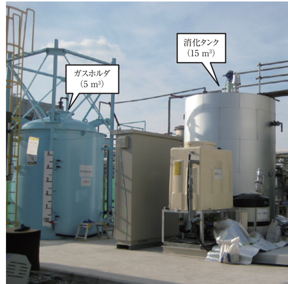
図6 実証試験装置（消化部）
