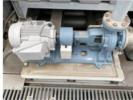
ポンプの振動と温度を収集・分析して異常を検知する
