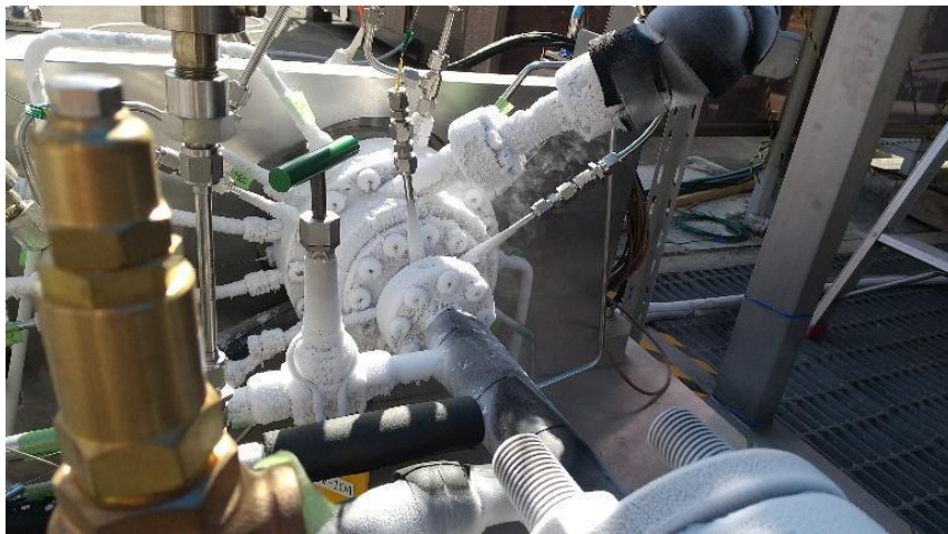
電動ポンプ試験機の様子 (JAXA 角田宇宙センター内にて)
